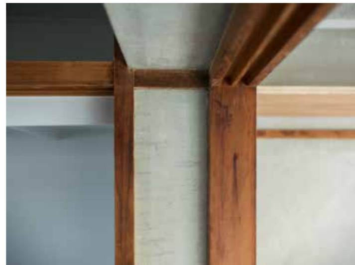
壁紙を丁寧に剥がしてコンクリートの素地を現しにし、 ふすまの木枠もそのまま生かしています。
