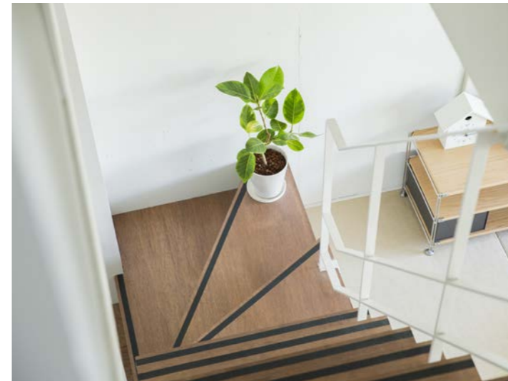
元々壁で囲われた階段だった部分の壁を撤去してスケルトンとし、手摺を新たに加え、光と風が通り抜ける階段になりました。
